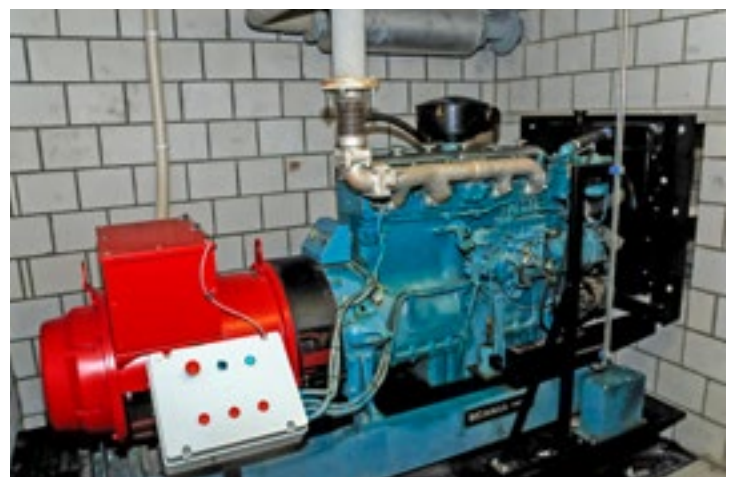
Le groupe électrogène de secours d'une puissance électrique impeccable a été acquis à bon prix par internet.
